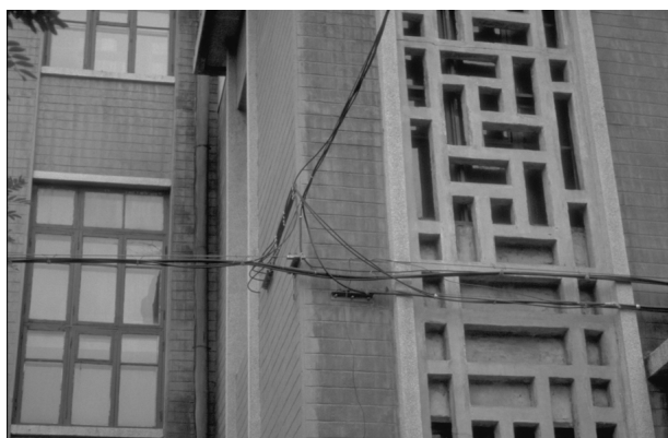
Bild 4: Freileitungen am zentralen Netzknoten
