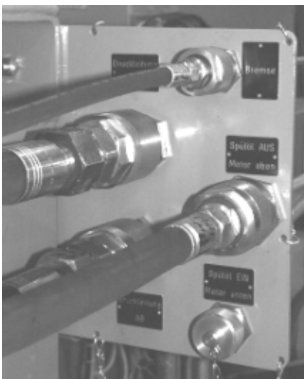
Bild 6: Hydraulikanschlüsse für die Prüfwinde
